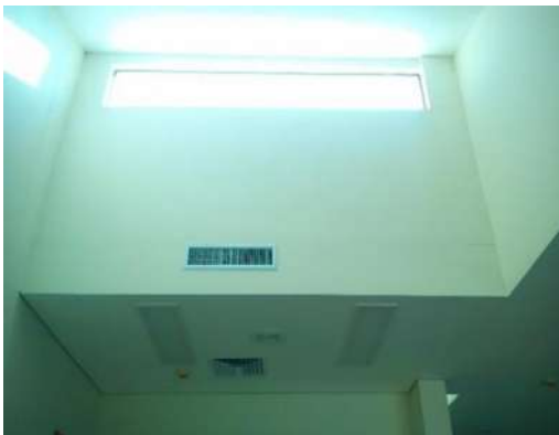
Fig. 14 Aire acondicionado por el espacio de guarda de equipos. Foto: Ivette Trinidad
