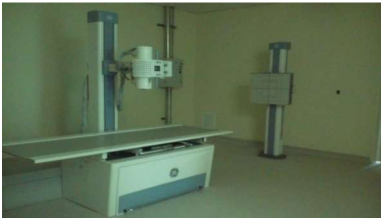
Fig. 13 Espacio y mobiliario de Rayos "X". Foto: Ivette Trinidad
