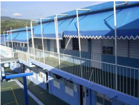
Imagen 5. Aulas en el Segundo Piso del Colegio CECH. Autor: Maurilio Hipólito Olivares. 10/12/2015.
