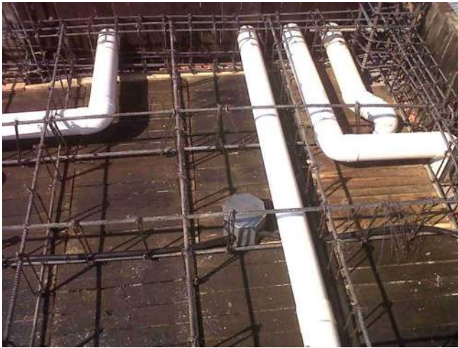
Imagen 58. Instalación sanitaria, cortesía del autor.
