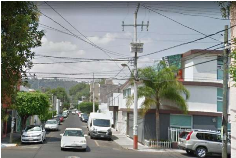
Imagen 15, transformador y arbotante, Google maps.
