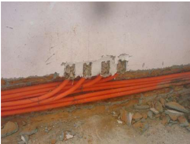
Imagen 59. Inst. Eléctrica (ductería), cortesía del autor.
