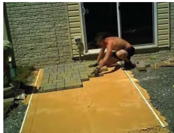
Figura 49: instalación de tabicon gris prensado foto: vídeo de youtube. Titulo: Paver Patio Installation - Fast motion [ https://www.youtube.com/watch?v=hL-bk7O5itA fecha de consulta: octubre 2017]
