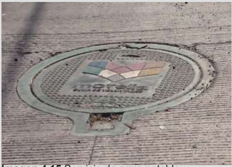
Imagen 4.15 Servicio de agua potable FUENTE: Autoria propia
