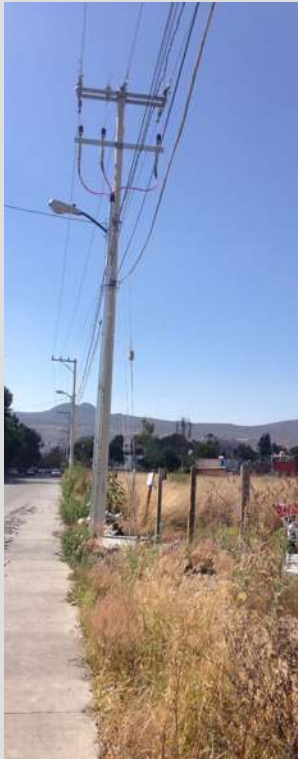
Imagen 4.16 Servicio de alumbrado público FUENTE: Autoria propia
