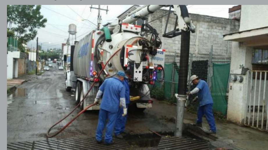
Imagen 30. Servicio de drenaje. Fuente: Google Imágenes
