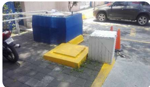
Fotografía 18 .- Área de Aljibe , bomba , Créditos: Paloma Cisneros Cortes, Fecha: 14/Abril/2018
