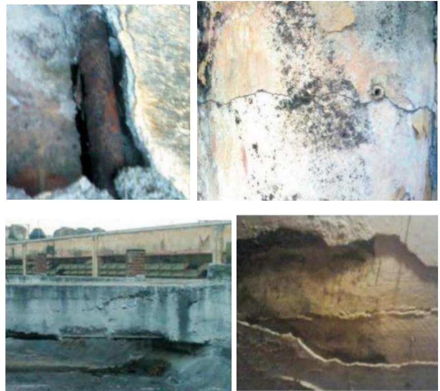
Fig.7. Daños sufridos en el interior del mercado municipal “18 de marzo”. Fuente: https://issuu.com/contactofaum/docs/un_espacio_publico_polivalente
