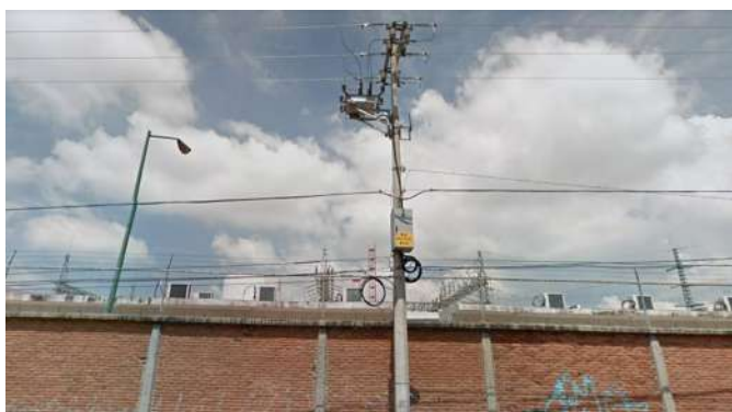
Img. 29 servicios de electricidad. Fotos tomadas por : Daniel Ziramba 2018
