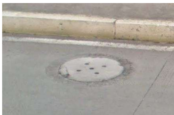
Img. 30 servicios drenaje y alcantarillado. Fotos tomadas por : Daniel Ziramba 2018
