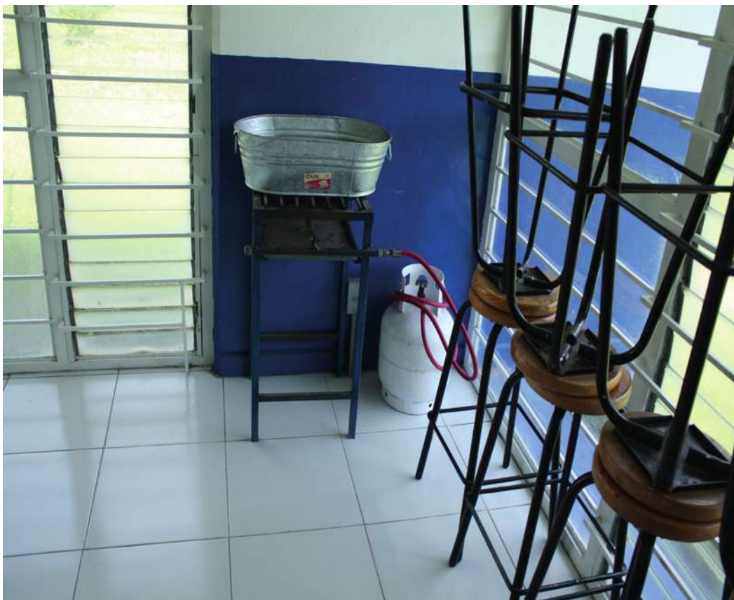
Fotografía 15: Instalación de gas en el laboratorio de practicas dentro de la clínica; Fotografía realizada por GSM. Sep. 2015
