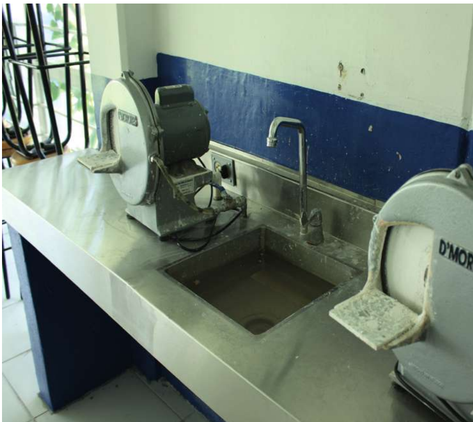
Fotografía 21: Instalación improvisada como decantador de yeso dentro del laboratorio de prácticas, fotografía tomada por el autor. Sep. 2015
