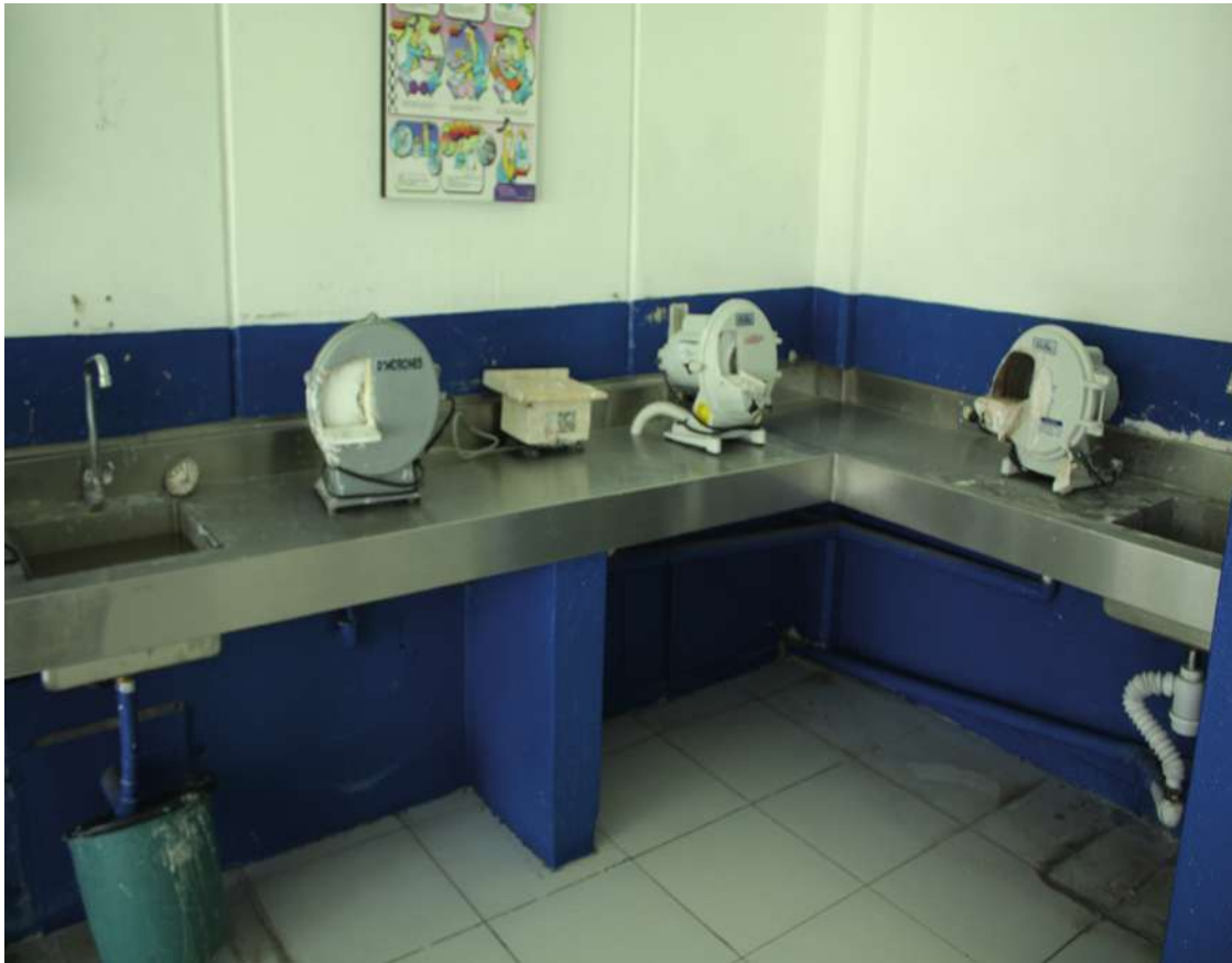
Fotografía 6: Laboratorio de practicas, donde se aprecia la instalación "hechiza" debajo del lavamanos, en el cespól. Sep. 2015 Fotografía tomada por GSM.
