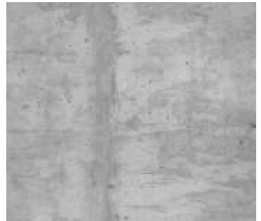
Imagen 51 Concreto con acabado aparente
