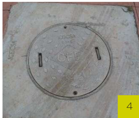
Fotografía 38. Registro eléctrico. Fotografía tomada por el autor.
