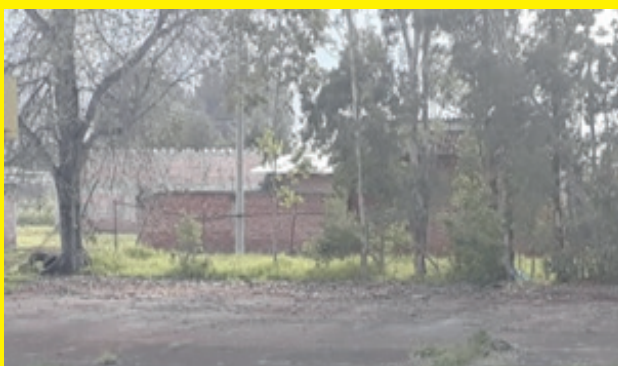
Imagen 2 Muestra la reja perimetral dañada por vandalismo lo que disminuye a la seguridad dentro de la unidad deportiva. Foto tomada por María Guadalupe Reyes Alvarez en sitio. El 25 de Agosto de 2018.
