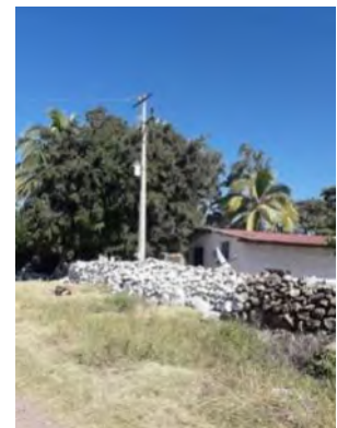
Imagen 4.17 Poste de alta tensión con transformador, Fuente: Marcela Vianney Gaona García, [19/11/2018]
