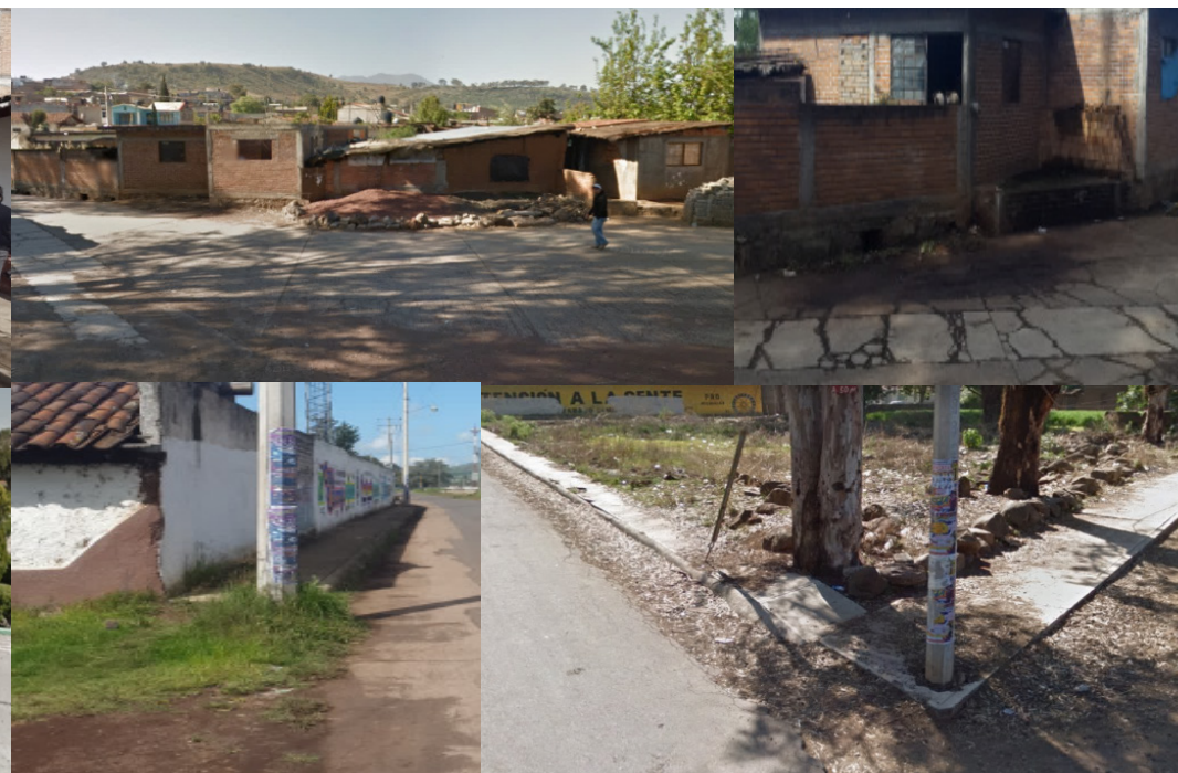
Figura 27. Conjunto de fotos de banquetas deterioradas en Lagunillas. Autor: LCA.
