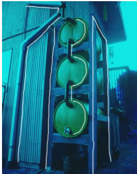
IMG 102. Sistema de captación agua pluvial y BAG
