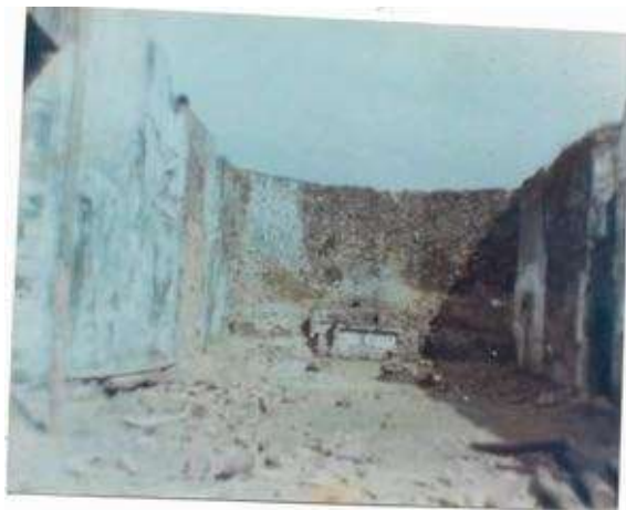
Ilustración 34 Fotografía del interior del templo después del incendio, Fuente: Encontrada en el ex convento de Santa Ana Zirosto, Fecha: Noviembre/2018
