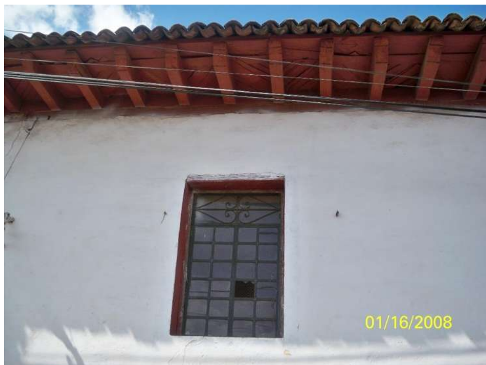
Deterioros: Piezas de vidrio faltantes en ventanas Fotos: Archivo Personal Fernando Hernández Huerta.
