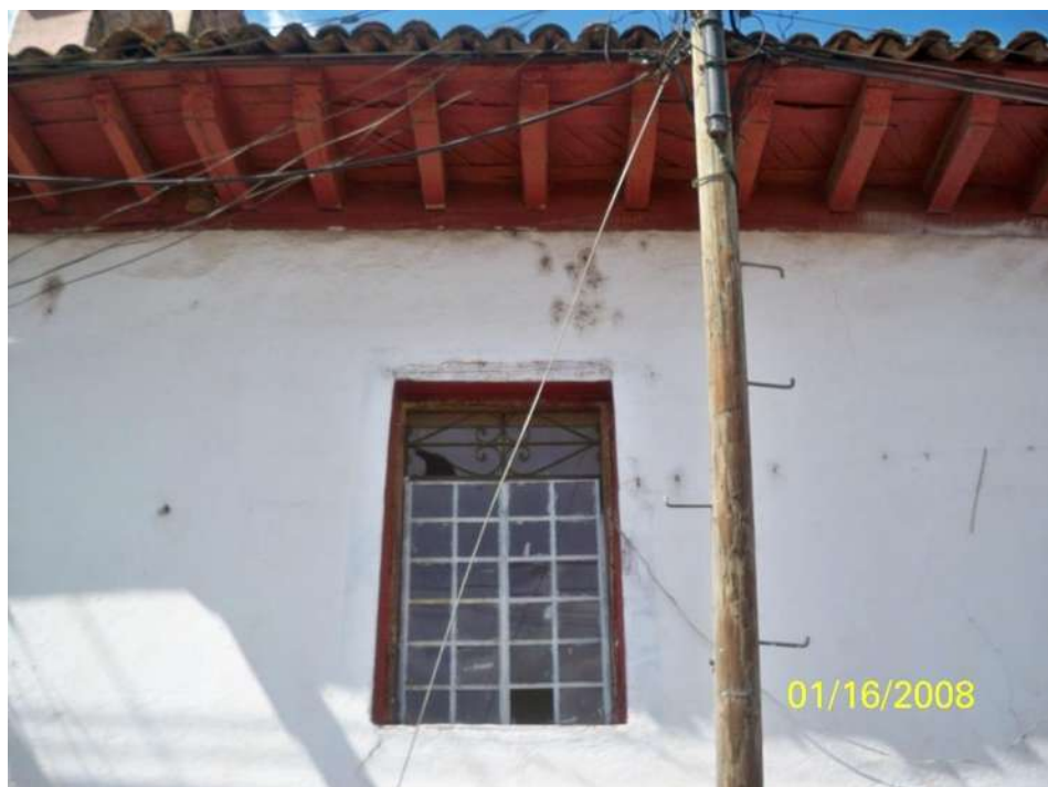
Deterioros: Grietas en muros. Piezas de vidrio faltantes en ventanas.
