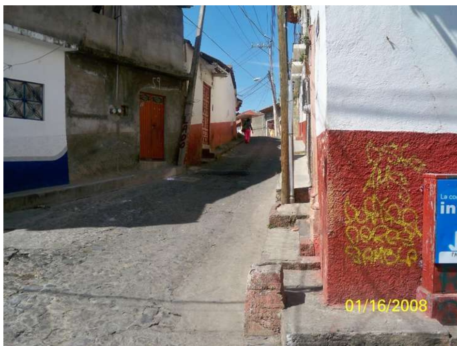
Deterioro: Grafiti en fachada.
