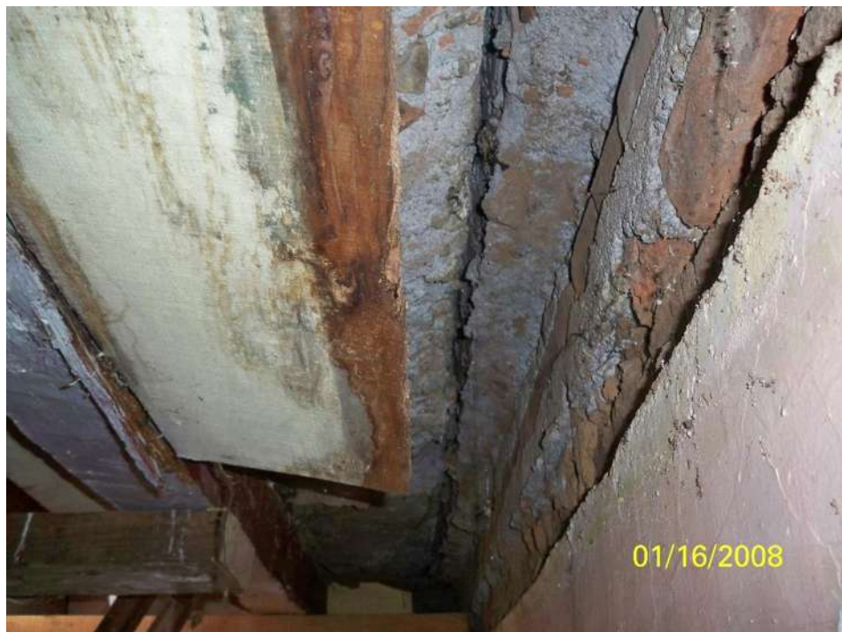
Deterioro estructural por faltante de vigas.
