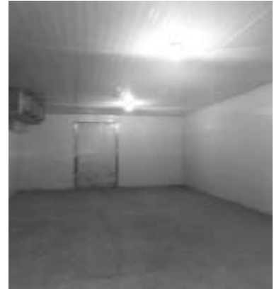
Imagen 15. Cámara frigorífica vacía. Fotografía tomada por R.M.G.
