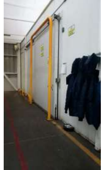
Imagen 67. Protección en puerta de cámara fría. Fotografía tomada por R.M.C.
