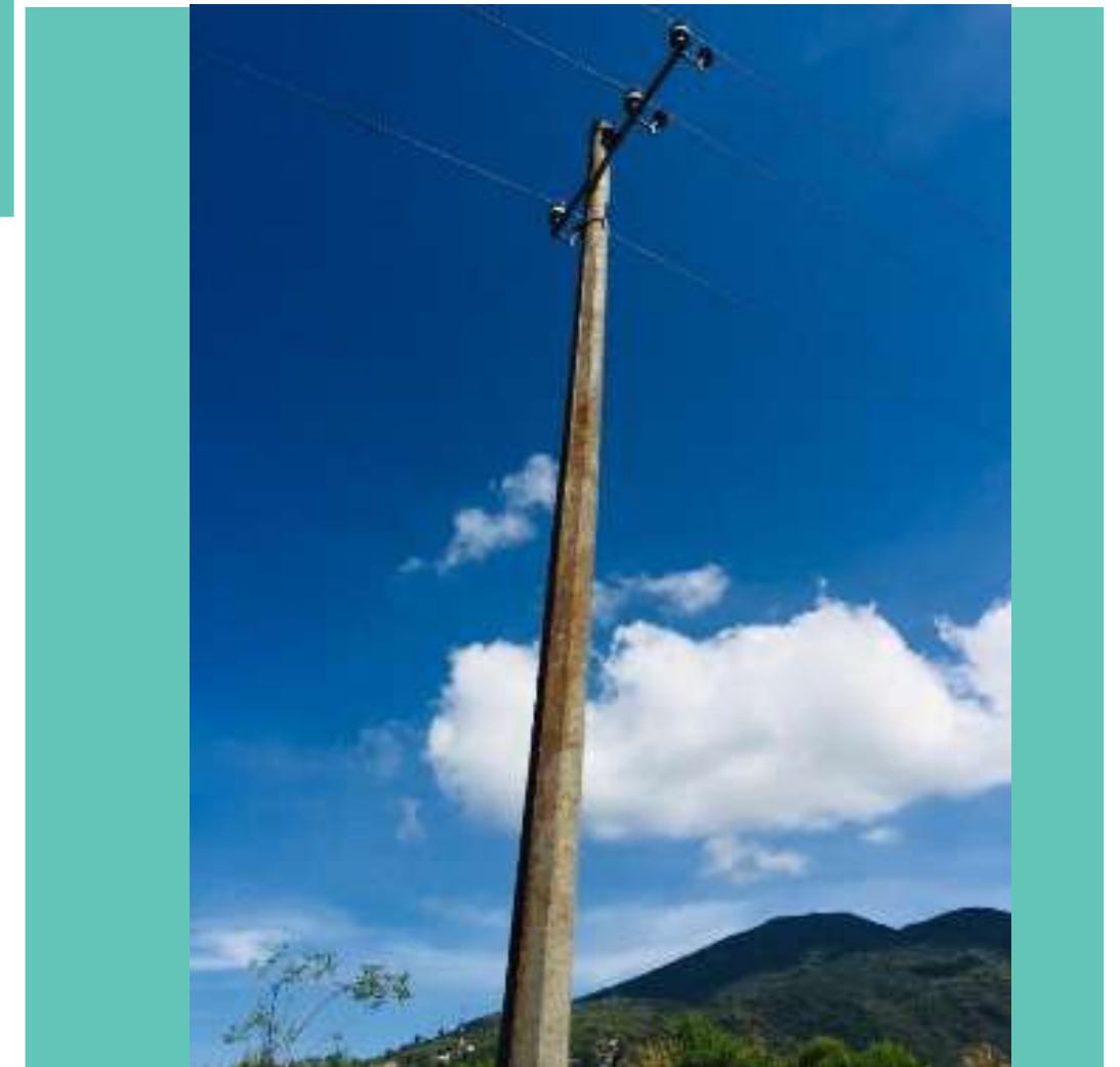
Imagen 50.-Fotografía propia. se cuenta con electricidad en el sitio.
