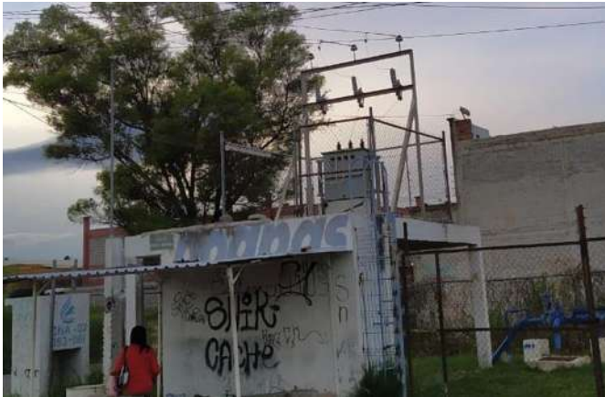
Imagen 36. Planta de agua potabilizadora.
