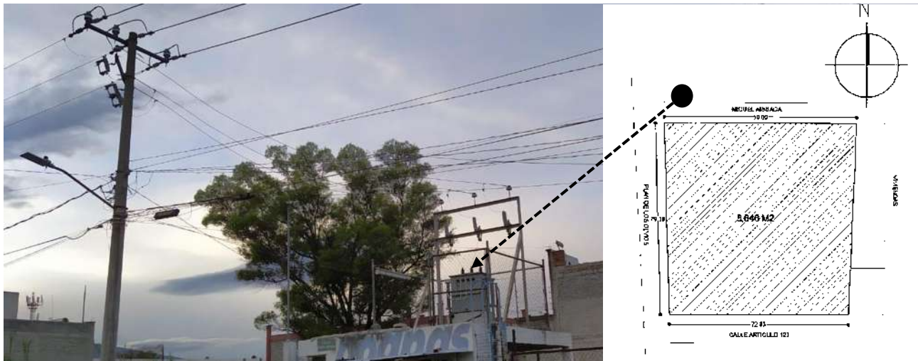
Imagen 33. Transformador eléctrico y planta de localización.
