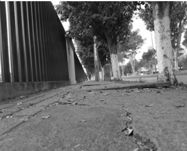
Ilustración 49 banquetas en mal estado (mucho desnivel) foto por Lizeth Yohana 09-nov-19
