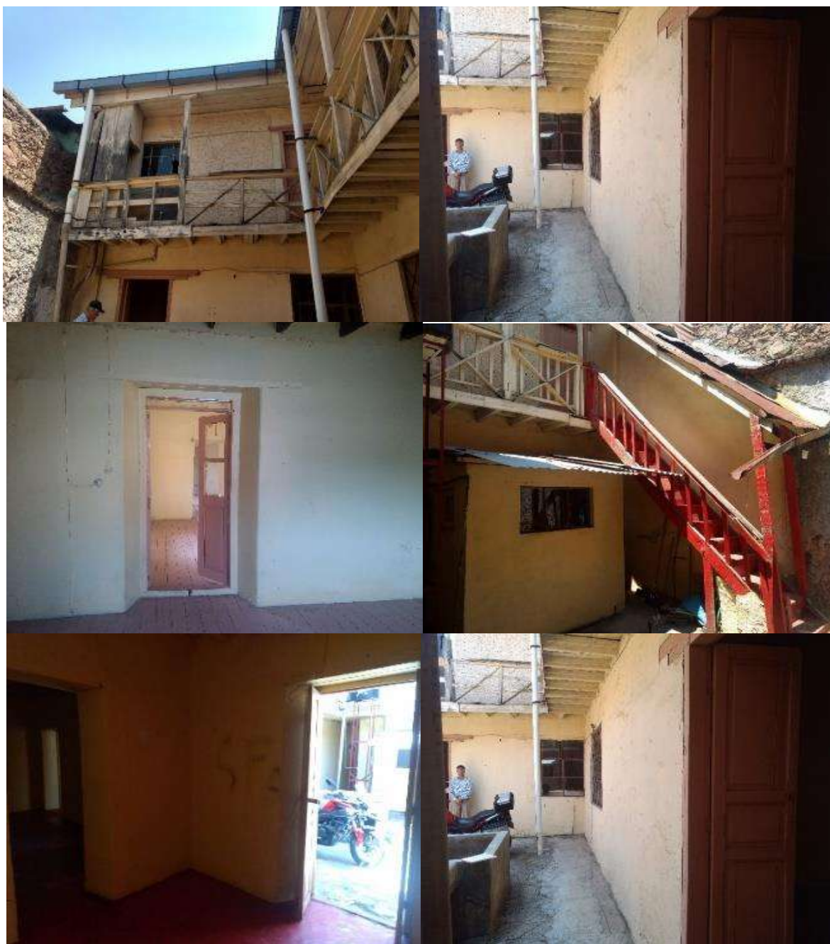
Ilustración 116. Seis imágenes tomadas del interior de la casa, la cual de adaptará y restaurara para uso de hospedaje (posada Familiar) y arrendamiento. En ellos se percibe los elementos dañados significativos por el paso del tiempo así adiciones o adaptaciones como mantenimiento de barandales, pasillos, columnas y pisos. También se percibe la necesidad de cambiar techumbres y plafones. Por último se puede apreciar la escalera en color rojo, acompañada de su techo, para ingresar a segundo nivel de la vivienda y a lado el único baño disponible en toda la vivienda.
