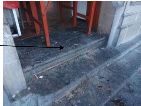
Imagen 20. Vista de las suciedades encontradas en pisos, escalones y paramentos.
