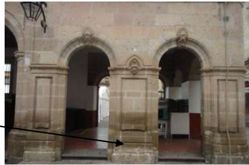
Imagen 12. Vista de los deterioros en los paramentos de la arquería.
