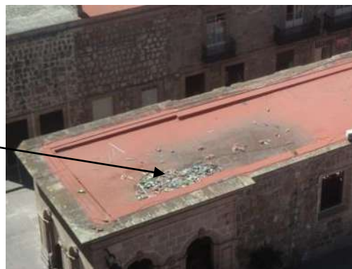
Imagen 27. Vista de la suciedad en cubierta
