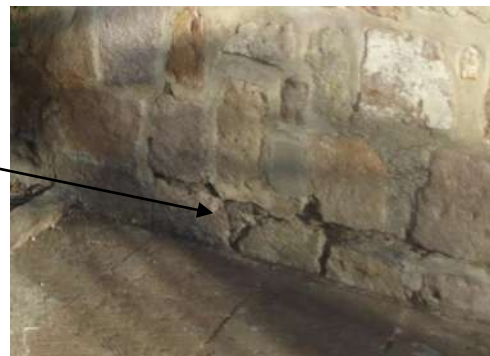
Imagen 16. Vista de la perdida de junta en paramentos Foto: Raymundo Alcalá
