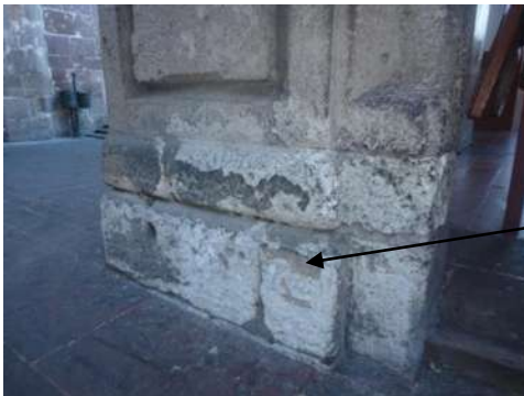
Imagen 13. Vista del deterioro de uno de los pedestales en arquería
