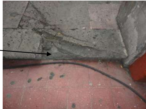
Imagen 18. Vista de las fracturas en escalones y pisos de cantería
