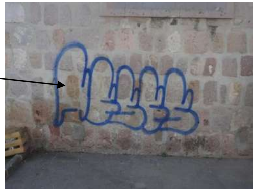
Imagen 24. Vista de los grafitis que afectan paramentos Foto: Raymundo Alcalá
