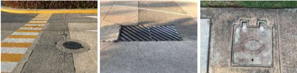
Ilustración 78. Imágenes tomadas por la autora. Infraestructura servicio sanitario y de agua potable.
