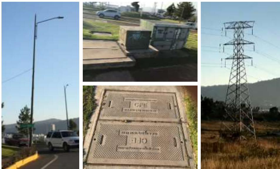
Ilustración 79. Imágenes tomadas por la autora. Infraestructura eléctrica del predio.
