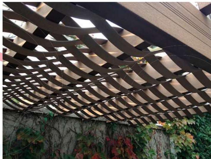
Ilustración 115. Utilización de cubiertas.
