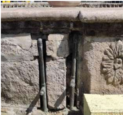
Fotografía 99. Fotografía Propia, 2020, alimentación de agua potable a la fuente, Nahuatzen
