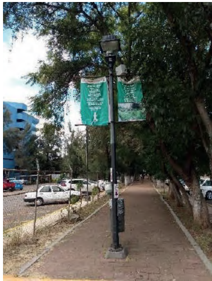
Ilustración 65. Alumbrado público. Tomada por autor.
