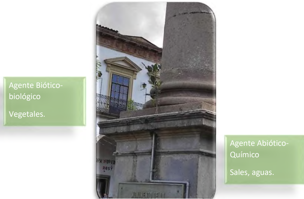
Ilustración 97 Ejemplo de agentes de deterioro.
