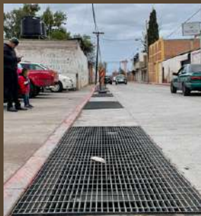
González, A. F. G. L. (2020, 08 octubre). «Alcantarillado» [Fotografía].
