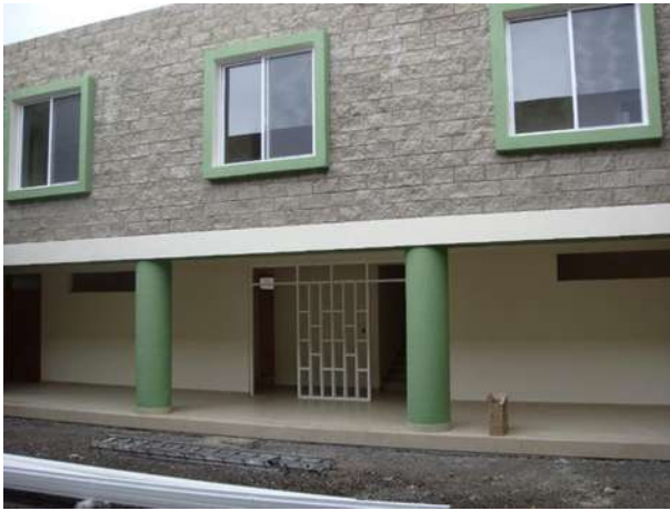
Imagen 53 Acceso área privada para subir segunda planta AHD
