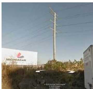
Torretas de alta tensión en la parte posterior del terreno
