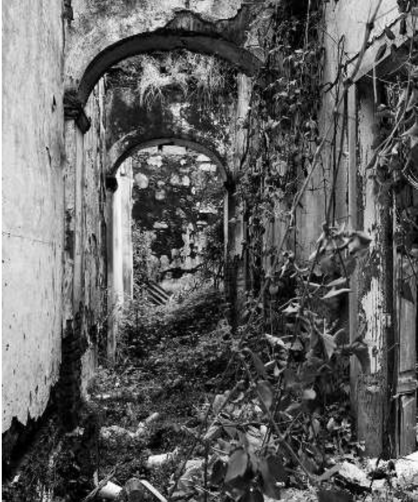
figura 1. Inmueble en riesgo de derrumbe en el Centro Histórico de Morelia. fotografía por Fernando Maldonado, 2019.
