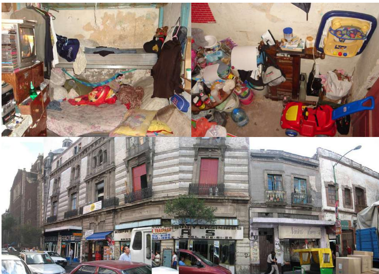
figura 78. Estado de conservación del inmueble. Fotografías por Javier Sánchez Arquitectos, Ciudad de México, 2012.
