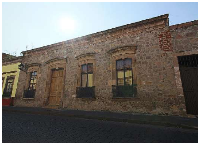
figura 22. apreciación de humedad por capilaridad en un muro de la fachada de una construcción en la zona de monumentos. fotografía autor anónimo Morelia, s/f.
