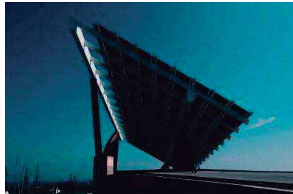
Figura 5. Panel fotovoltaico instalado en azotea.
