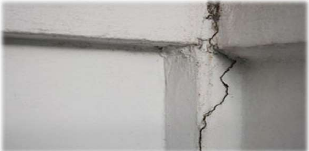
Imagen 3. Fuente: Propia tomada con el celular, se observan columnas y travesaños fracturados.
