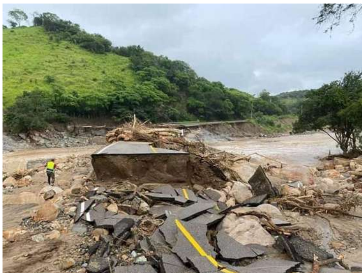
Imagen 07. Derrumbe en carretera Arteaga-Lázaro Cárdenas, Mich. El sol de Morelia.
