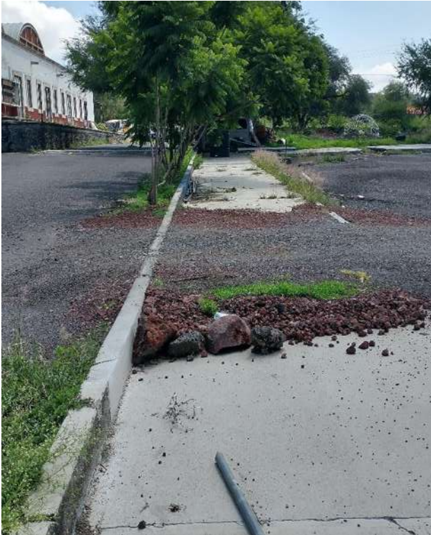
Ilustración 22. Acera colindante con la vía secundaria al terreno. Archivo personal.
