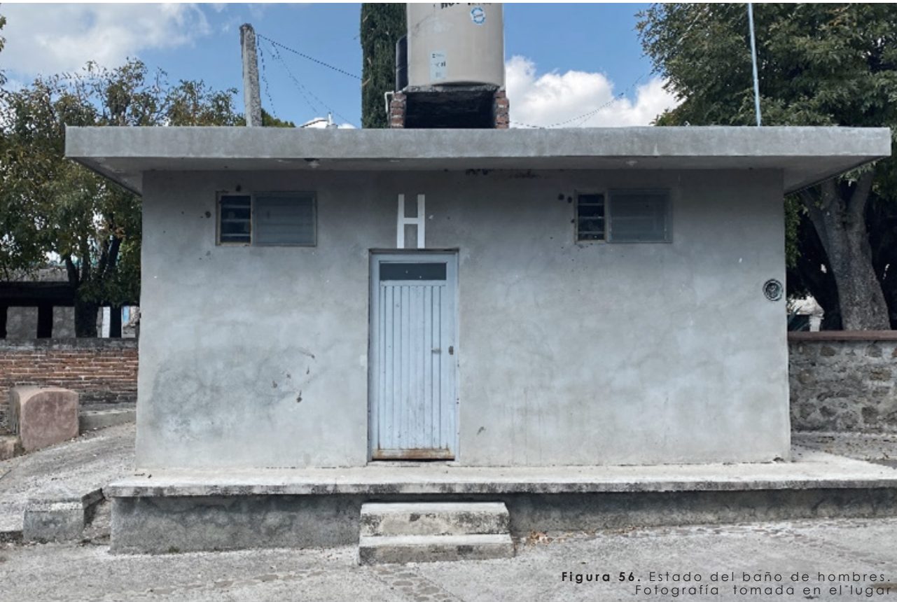
ESTADO DEL BAÑO ANTERIORMENTE
