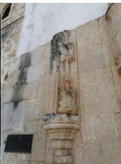
Fotografía 13. Deterioro de la fachada del templo. FGO
