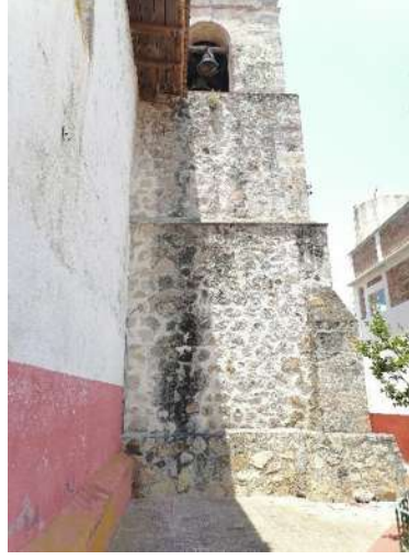
Fotografía 17. Deterioro de la fachada del templo. FGO
