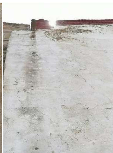
Fotografía 14. Deterioro de la fachada del templo. FGO
