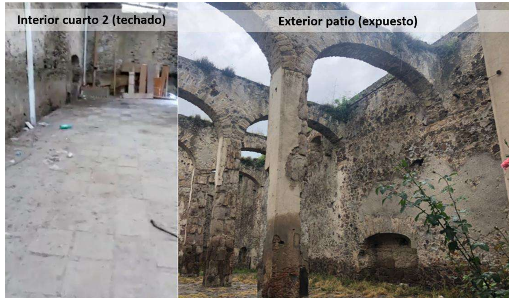
Figura 49. Comparación de humedad en muros. Fuente: Imagen propia
