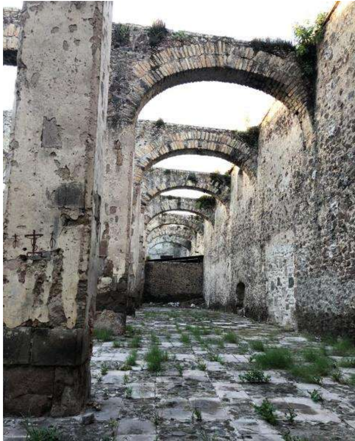
Figura 1. Deterioro interior. Fuente: Elaboración propia
