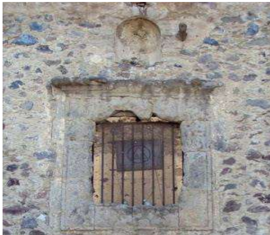
Figura 51. Deterioro en ventanas. Fuente: vamonosalbable.blogspot.com
