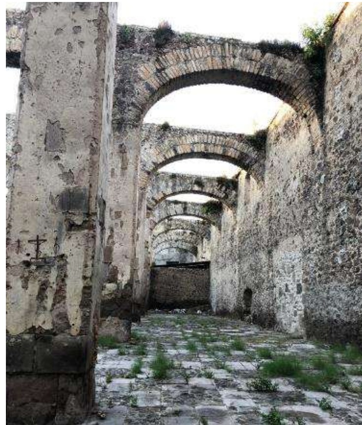
Figura 56. Crecimiento de vegetación en arcos y piso. Fuente: Elaboración propia.
