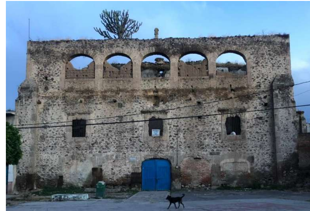
Figura 50. Deterioro de fachada Nor-oeste. Fuente: Elaboración propia.
