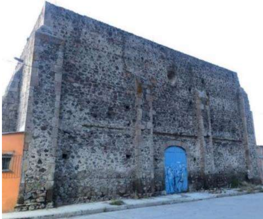
Figura 54. Deterioros fachada Sur-este. Fuente: Elaboración propia.
