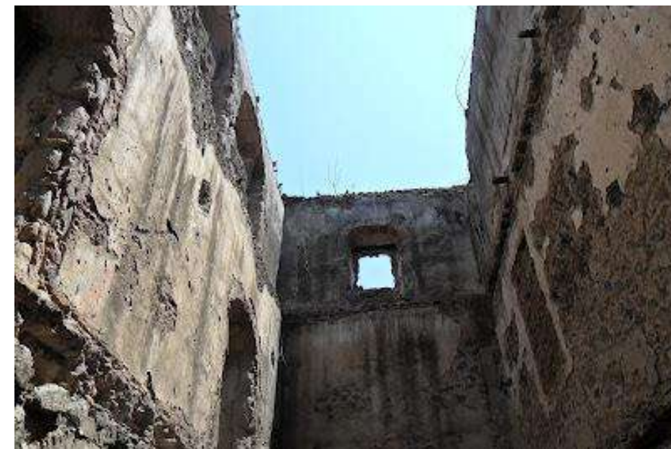
Figura 57. Deterioro de recubrimiento. Fuente: Elaboración propia.
