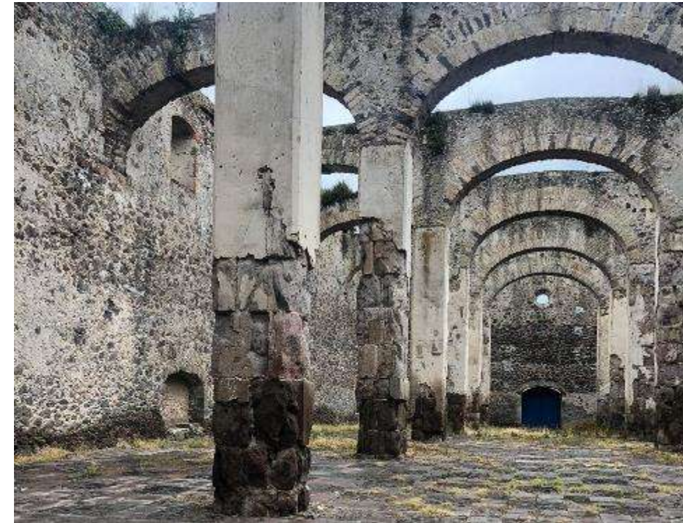
Figura 55. Desprendimiento de recubrimiento en columnas. Fuente: Elaboración propia.
