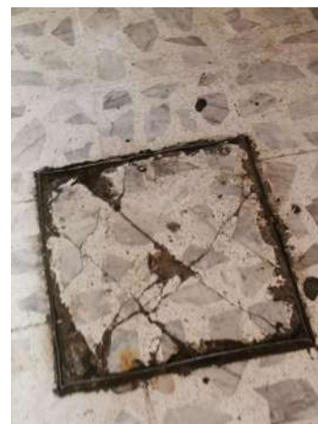
Fig. No 33 Las tapas de los registros hidrosanitarios se encuentran quebradas, por lo que salen olores.
