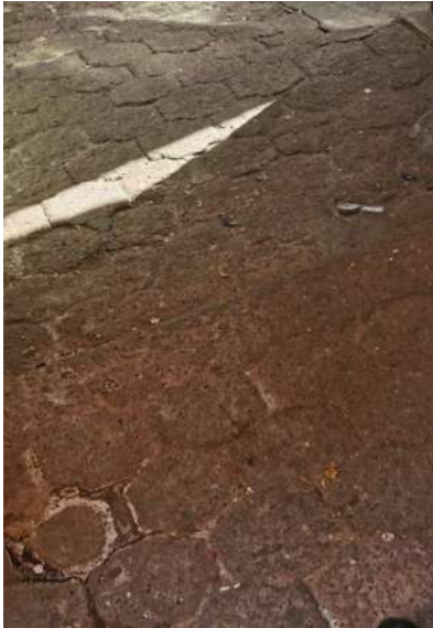
Fig. No 34 El piso exterior del mercado, conformado por adoquines labrados, por el tránsito de tanta gente y los años de vida que tienen ya presentan un estado muy malo, están desgastados
