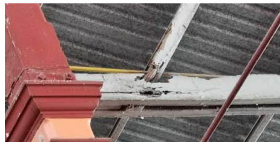
Fig. No 36 Viga de madera la cual forma parte de la estructura de la techumbre, se observa en muy mal estado.
