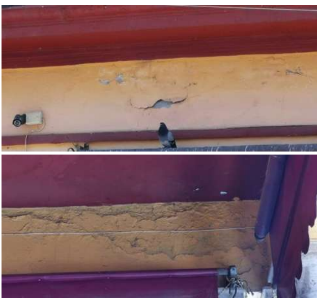
Fig. No 41 desprendimiento del aplanado original en partes de la fachada
