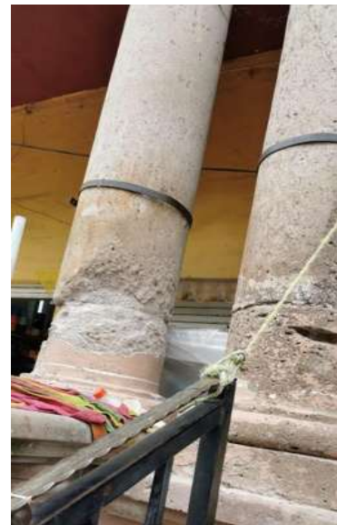
Fig. No 38 Las columnas de la fachada sur son las más desgastadas ya que son las que están a diario en contacto con muchos factores que las desgastan.
