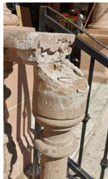
Fig. No 40 Los pasamanos de la fachada sur están quebradas por golpes fuertes han quedado en este estado y no han recibido ningún trabajo para devolverles su forma original.
