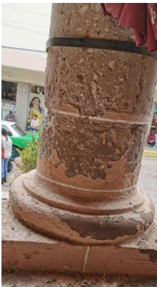
Fig. No 37 Las columnas de la fachada sur son las más desgastadas ya que son las que están a diario en contacto con muchos factores que las desgastan.
