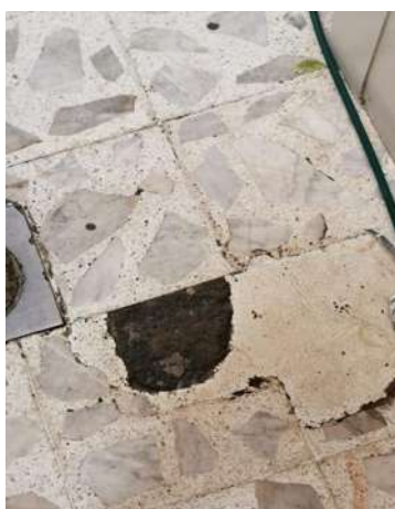
Fig. No 32 Debido a exceso de fuerza y goles recibidos con algunos objetos el piso se encuentra quebrado y se ha intentado tapar los daños con otros materiales.
