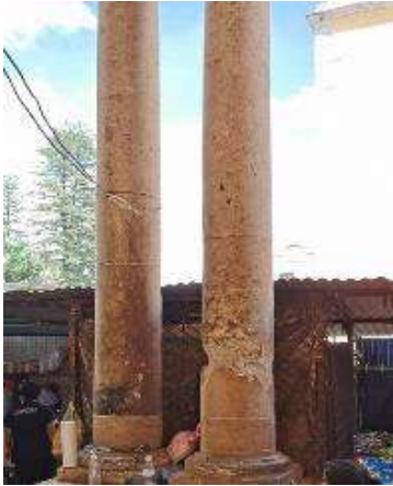
Figura No. 3 Estructura dañada
