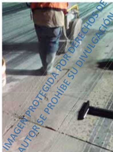
Ilustración 19. Corte de perímetro de desconchamientos para el aeropuerto, archivo personal T.Y.L.L.
