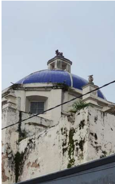
desprendimiento de Pintura, crecimiento de vegetación y musgo en la cúpula central, Septiembre 2021 Fotografía Lizbeth Pérez
