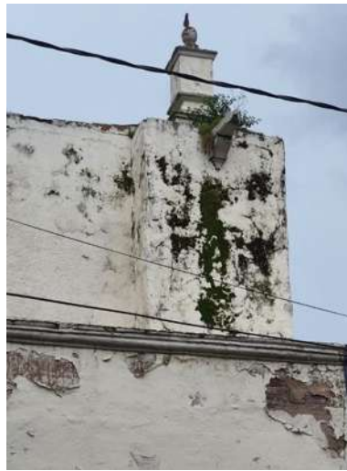
Estado actual crecimiento de Musgo, vegetación y desprendimiento de Pintura en Fachada Norte, Septiembre 2021 Fotografía Lizbeth Pérez
