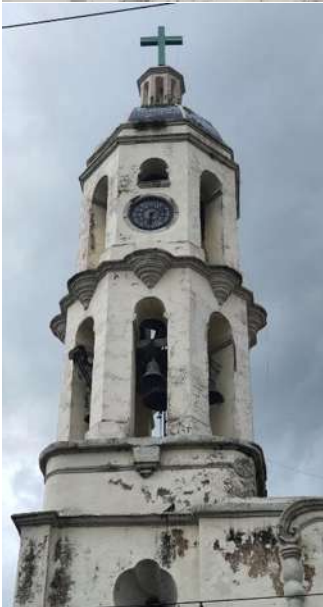
desprendimiento de Pintura y crecimiento de vegetación en Torre mayor, Septiembre 2021 Fotografía Lizbeth Pérez
