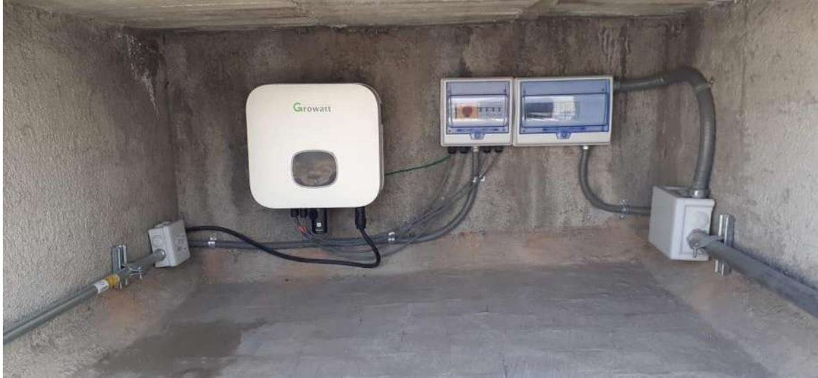
Figura 4.17 Vista del Inversor y Protecciones montadas (Fuente: elaboración Propia).
