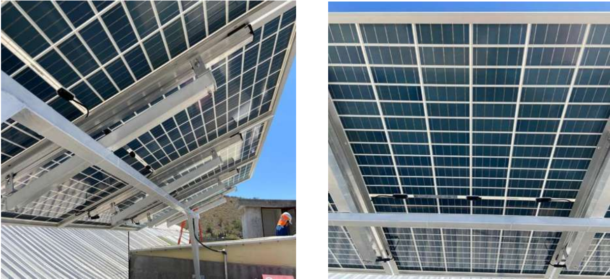
Figura 4.16 Vista de los Paneles de la Parte Bifacial (Fuente: elaboración: Propia).
