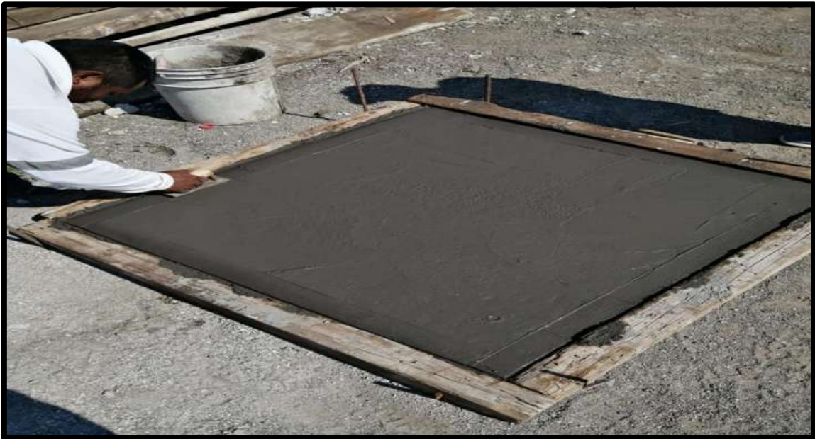
Figura 3.1.6 (Evidencia de fabricación de firme para pruebas de utilización en otros aspectos de construcción)
