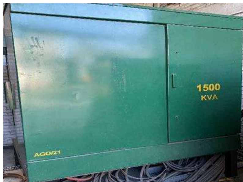
Figura 4.17: Subestación de 1500 KV
