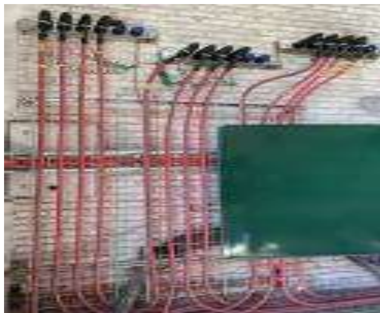
Figura 4.19: conectores de subestaciones.
