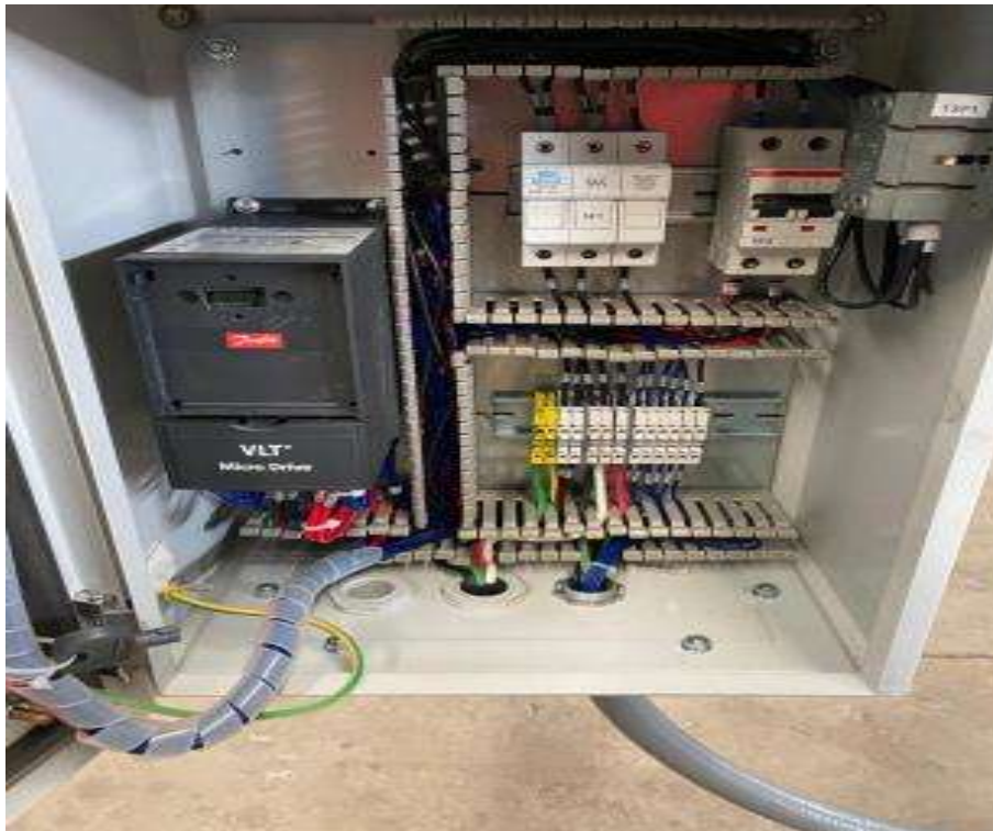
Figura 4.12: Tablero de control.
