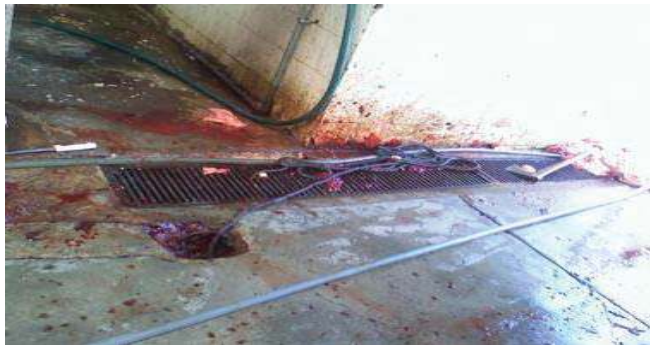
Imágenes que nos muestran paredes de material lavable pero se encuentran muy sucias (Puruandiro)
