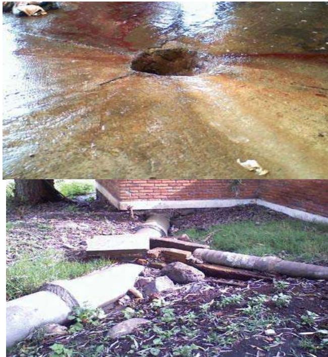
Imágenes que nos muestra un inadecuado drenaje ( Villa Jiménez, Panindícuaro.)
