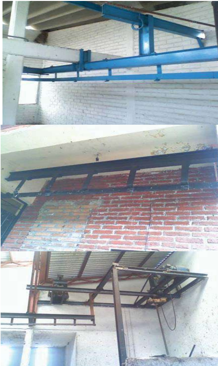
Imágenes que muestran que si cuentan con el riel de suspensión y lo usan en ( Angamacutiro, Panindícuaro, y Puruándiro)
