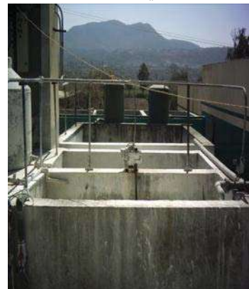
PLANTA TRATADORA DE AGUAS IMAGEN #10
