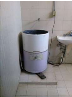
Fig. 53 No se cuenta con la mezcla de agua caliente y fría, solo se tiene una lavadora en la cual lavan la vestimenta de trabajo.
