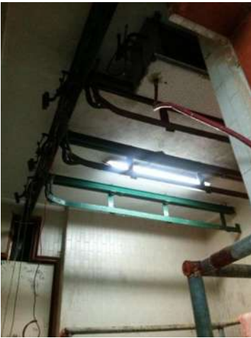
Fig. 58 Se cumplen con los 90 cm. entre el riel y los muros.
