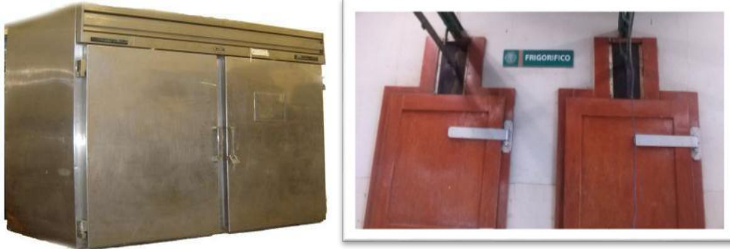
Fig.12 Área de refrigeración se cumple con la norma oficial mexicana.
