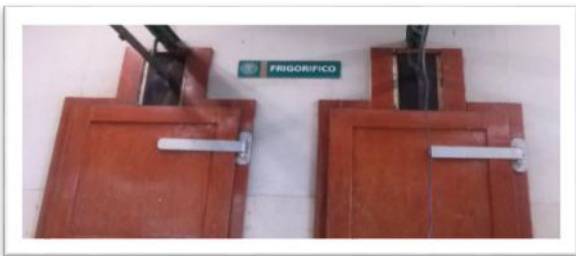
FIG.28 Cámara frigoríficas de la posta zootécnica
