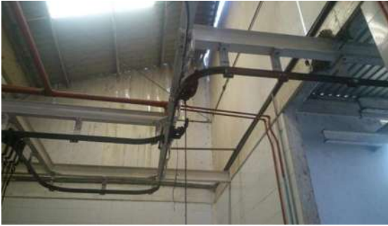
Fig. 56 Riel de transporte de la canal
