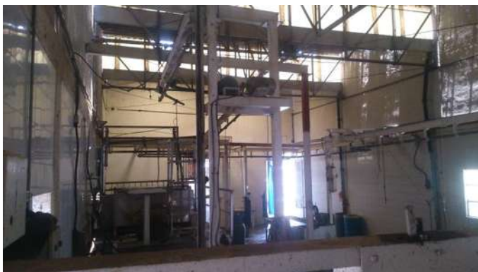
Fig.31 como se encuentran los rieles en el rastro municipal de Acámbaro Guanajuato los cuales están dentro de lo que nos indica la norma.
